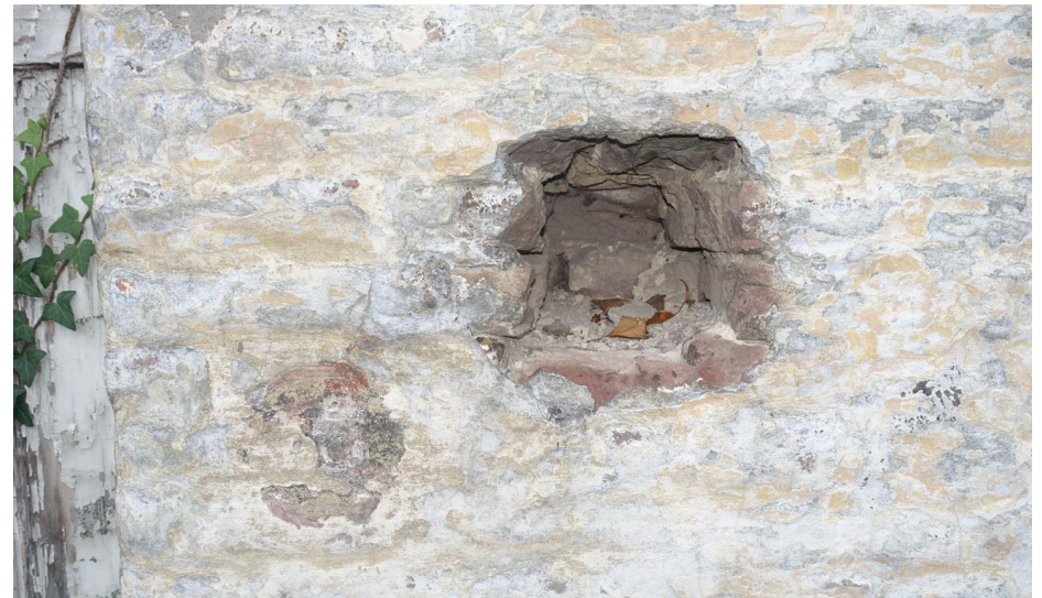
Fig. 26 Details van de recent aangebrachte gaten in het noordelijke deel van de westgevel.
