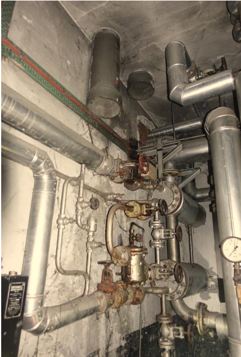
Afb 23 Verwarmingsketel in ruimte D1.
