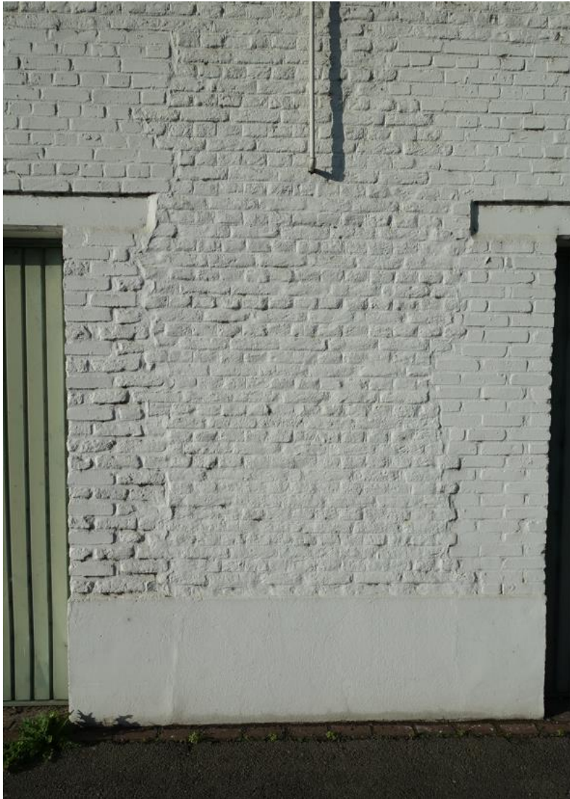
Fig. 43 In sommige gevallen is bij latere gevelopeningen veel oorspronkelijk metselwerk verdwenen, zoals hier bij een van de twee garagedeuren in het zuidelijke deel van de gevel. Boven de latei en langs de dagkanten is een groot vlak aan inboetwerk te zien.
