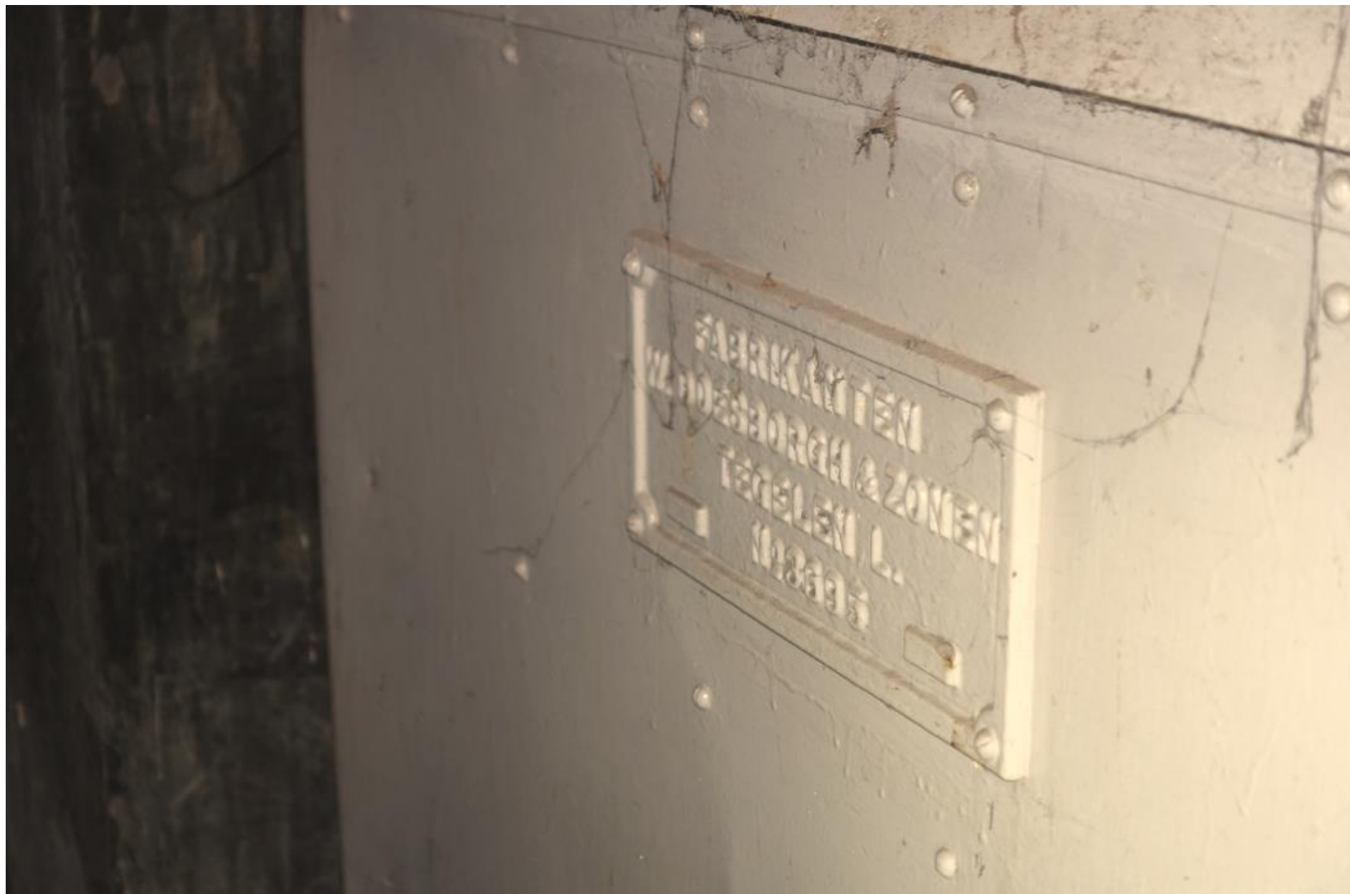
Afb 25 Detail verwarmingsketel in ruimte D1: FABRIKANTEN W. DOESBORGH & ZONEN TEGELEN L. No. 3695.
