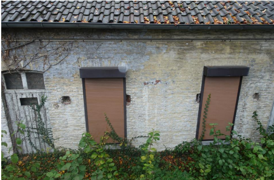
Fig. 25 Aan de noordzijde van de keermuur zijn verschillende gaten te zien in de westgevel. Wellicht houden deze verband met de recente ophoging van het terrein hier.
