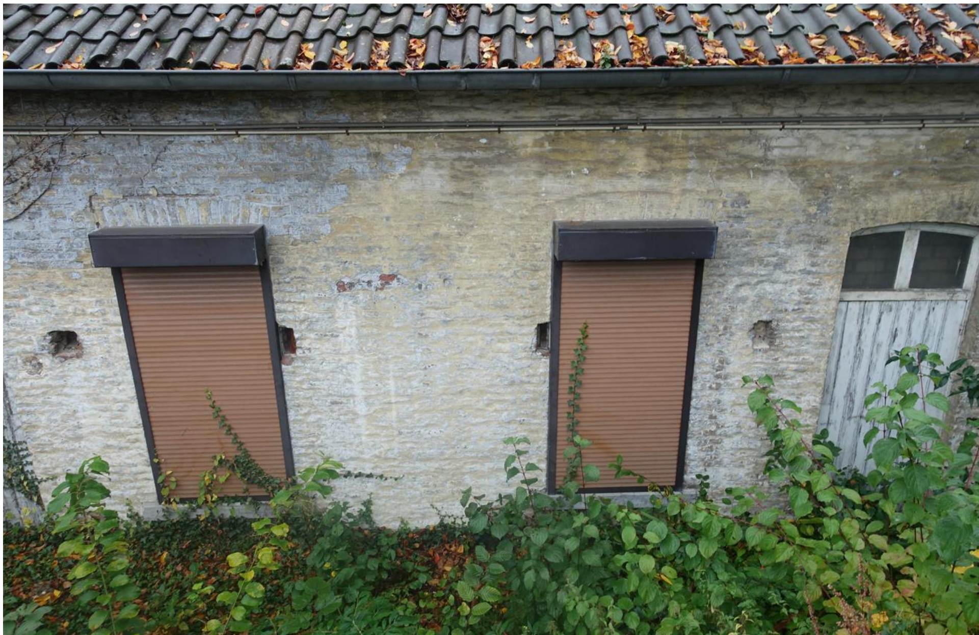
Fig. 16 Aan de noordzijde van de keermuur is het inboetwerk rond de gevelopeningen in de westgevel minder duidelijk zichtbaar. Wellicht komt dit door het dikke pak aan gevelafwerkingen.
