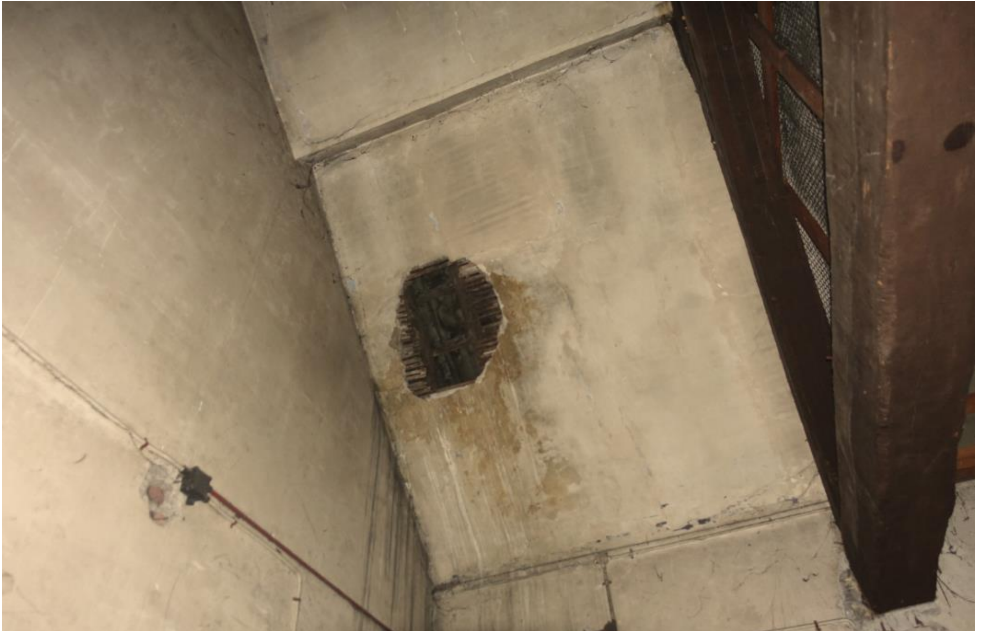
Afb 11 Stucwerk op tengels uit 1940 bij de dakvlakken boven ruimte B.
